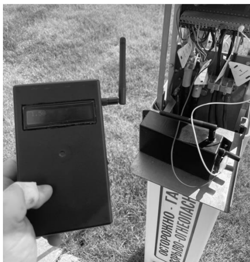
Рис. 2. Внешний вид мобильного и стационарного устройств
